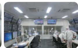
コントローラー室
